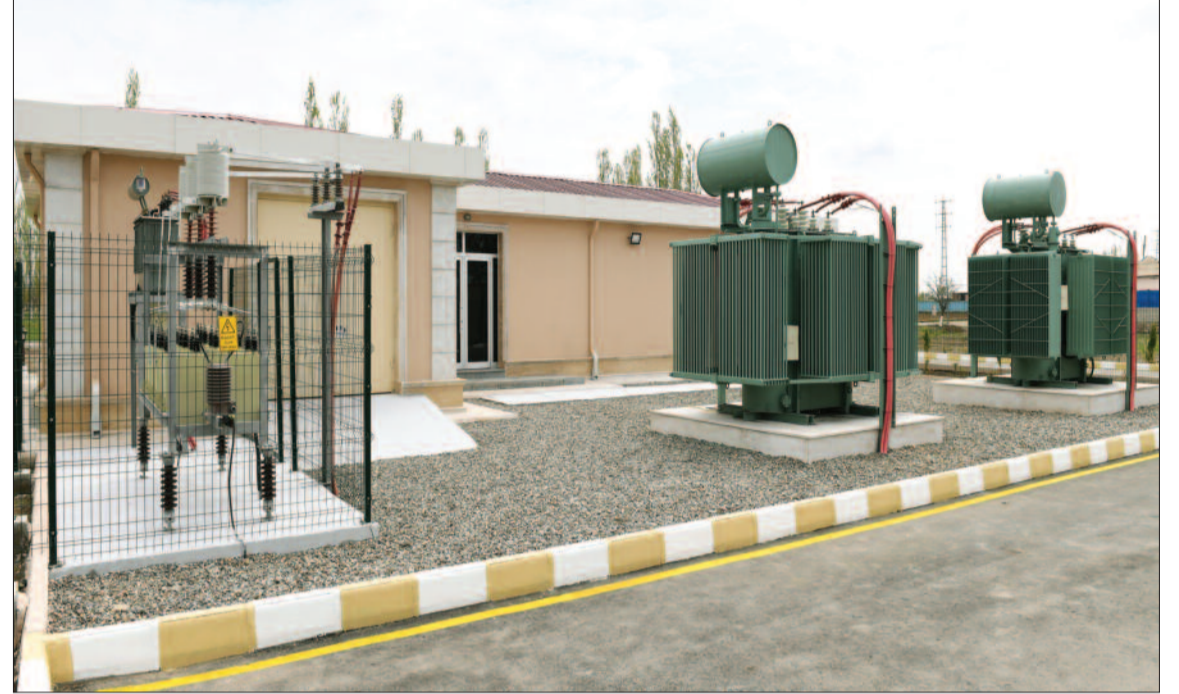
Şərur rayonunda "Çomaxtur" elektrik yarımstansiyası
